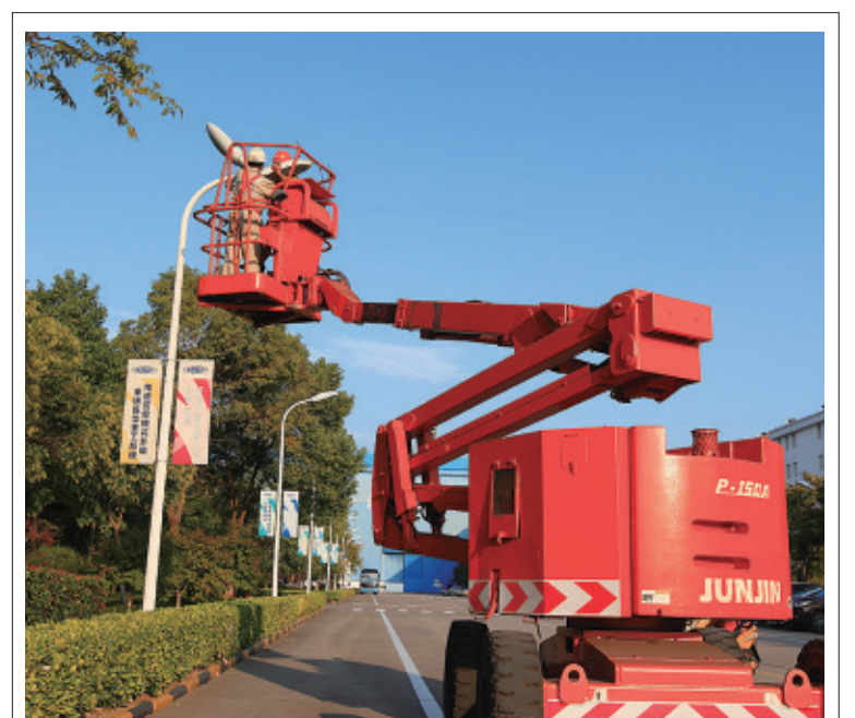
近日,振华重工所属南通传动为厂区更换80盏LED路灯,并设置了夜间亮灯调控程序,在保障照明的同时节约能耗。 保建军 摄影报道
